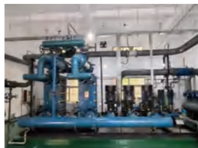
改造后的西区换热站机组
